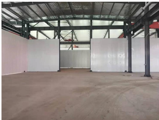
车间现状照片
