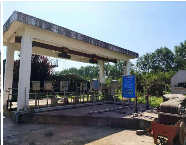
格栅泵站现状
