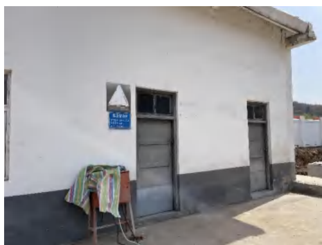
现有危废暂存间
