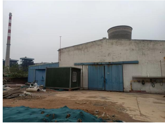
在建纤维板线车间
