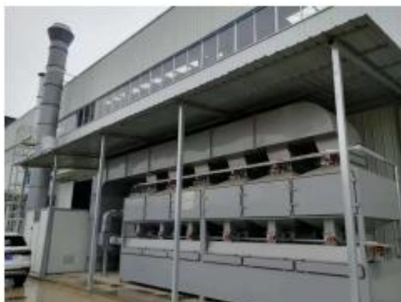
依托现有工程喷漆废气处理设施 (干式过滤+活性炭吸附+催化燃烧)
