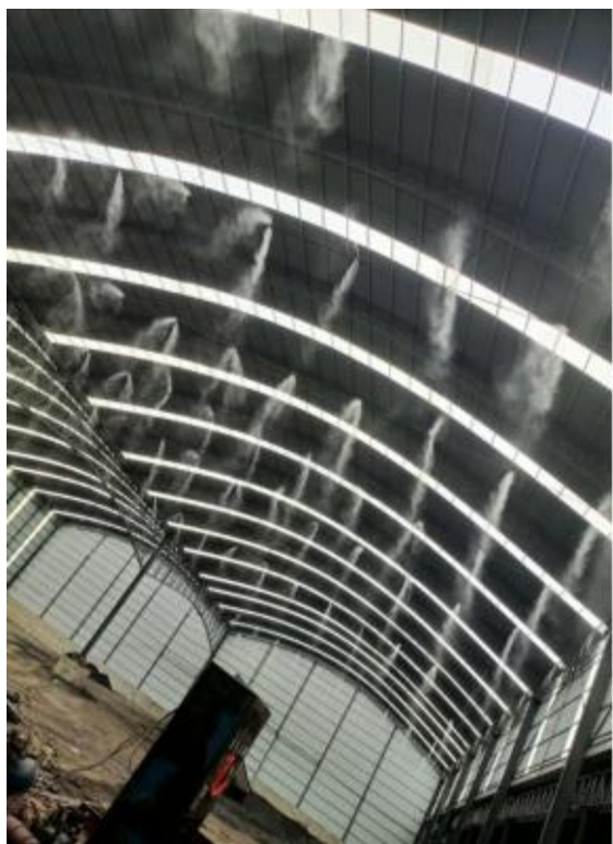
车间喷淋设施
