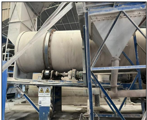
现有工程设备现状
