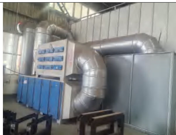
现有喷漆房废气治理设施
